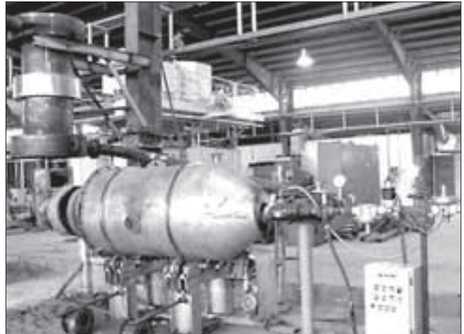
▲ شکل ۳- سیستم سوخت‌رسانی طراحی و اجرا شده توسط شرکت شعله صنعت برای گازسوز کردن یک کوره دوار ذوب چدن ۵۰۰ کیلوپی در شرکت نوین ستاره کاسپین
